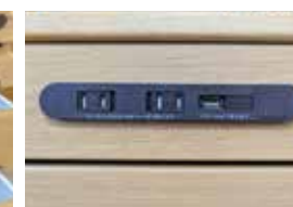
コンセント関係も完備しています。
